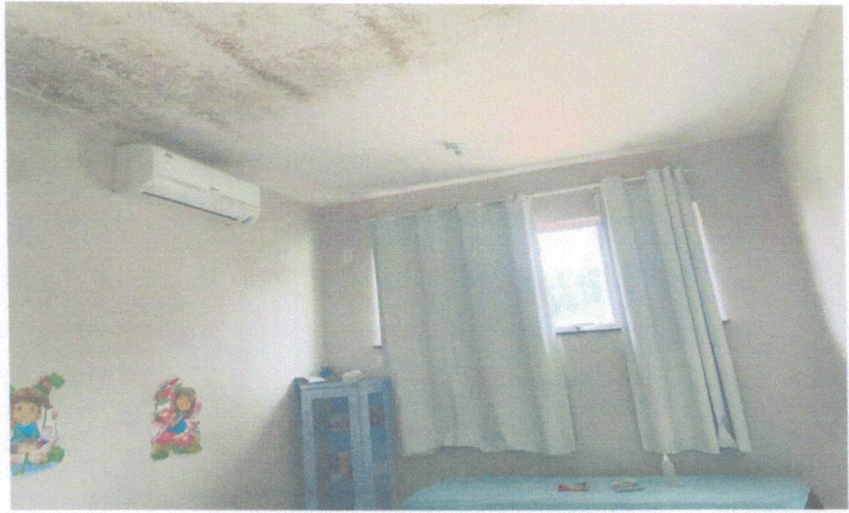
Foto 02 – Consultório com problemas de infiltração na cobertura.
