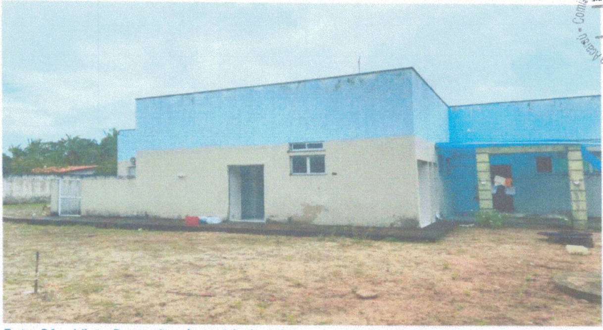
Foto 01 – Vista Posterior da Unidade Básica necessitando de pintura e reparo de cobertura de policarbonato.
