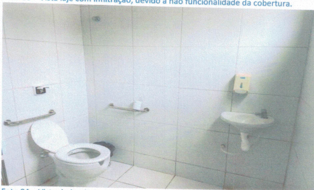
Foto 04 – Vista do banheiro com mau funcionamento da instalação hidráulica.
