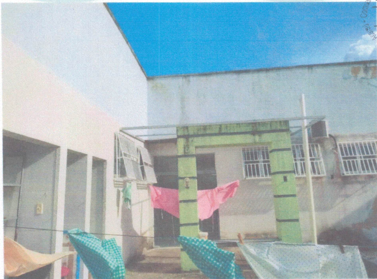
Foto 05 – Problemas na cobertura de policarbonato, necessitando de substituição.
