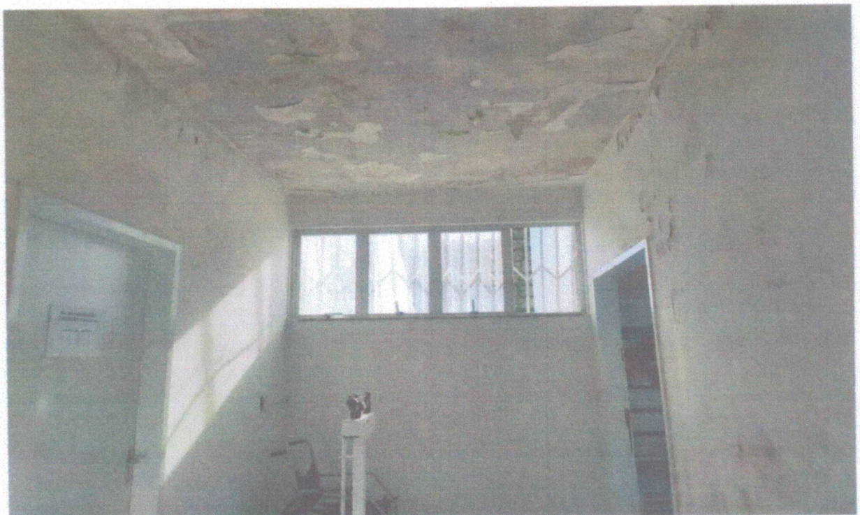
Foto 02 – Corredor com problemas de infiltração do telhado.
