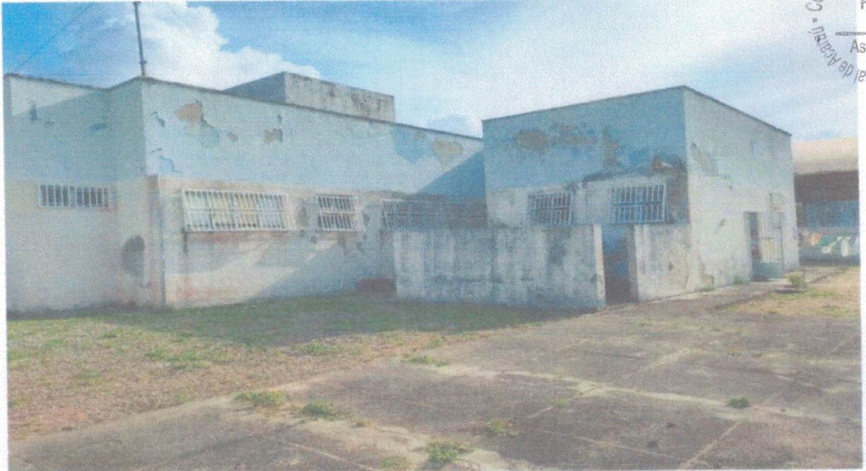
Foto 01 – Vista Posterior da Unidade Básica necessitando de pintura e reparo no revestimento.
