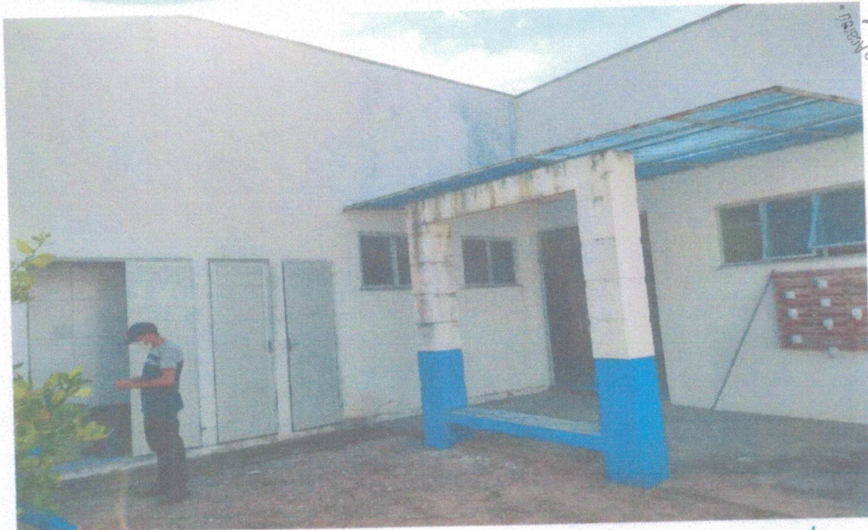
Foto 01 – Vista Posterior da Unidade Básica necessitando de pintura e reparo de cobertura de policarbonato.
