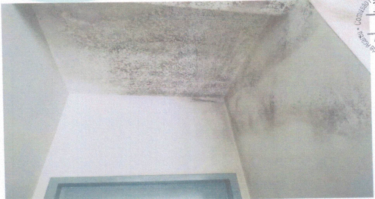
Foto 03 – Vista do forro com infiltração.
