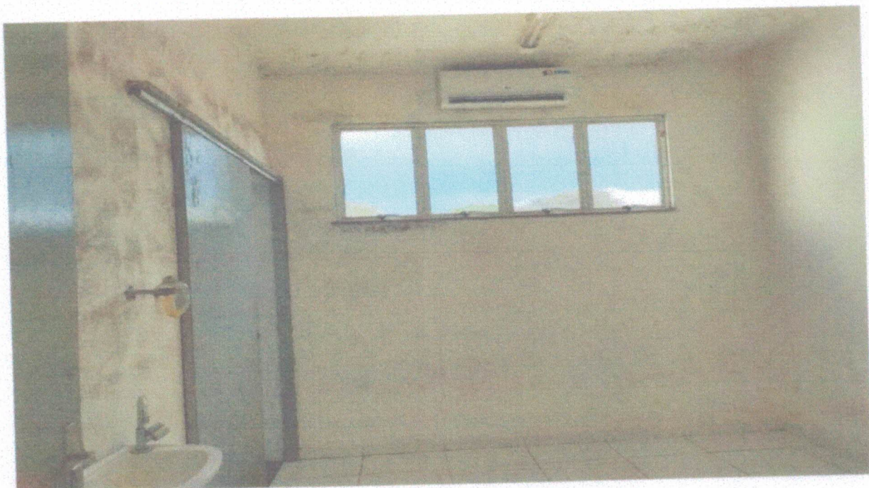
Foto 02 – Sala com problemas de infiltração.
