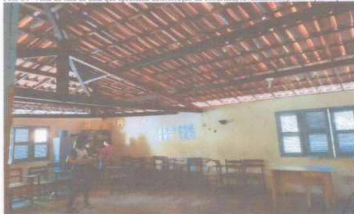
Foto 04 -Vista da sala de aula que apresenta deterioração da cobertura, revestimento, janelas, piso e portas
